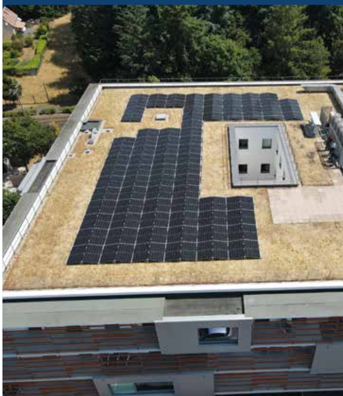
Centrale photovoltaïque en autoconsommation installée en mai 2025 sur le toit de notre siège, Obeya.
